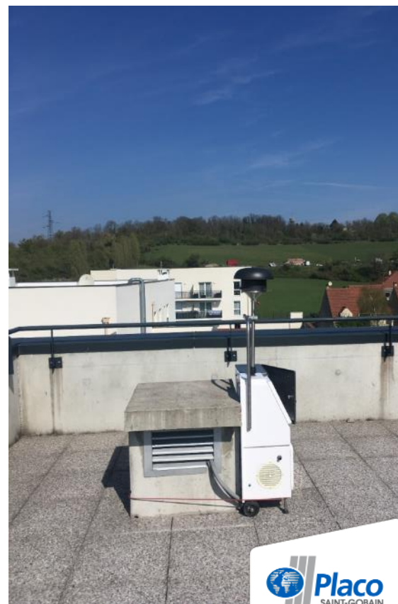
Installation balise env. à Courtry
